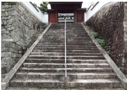
修復前の石段及び石垣
